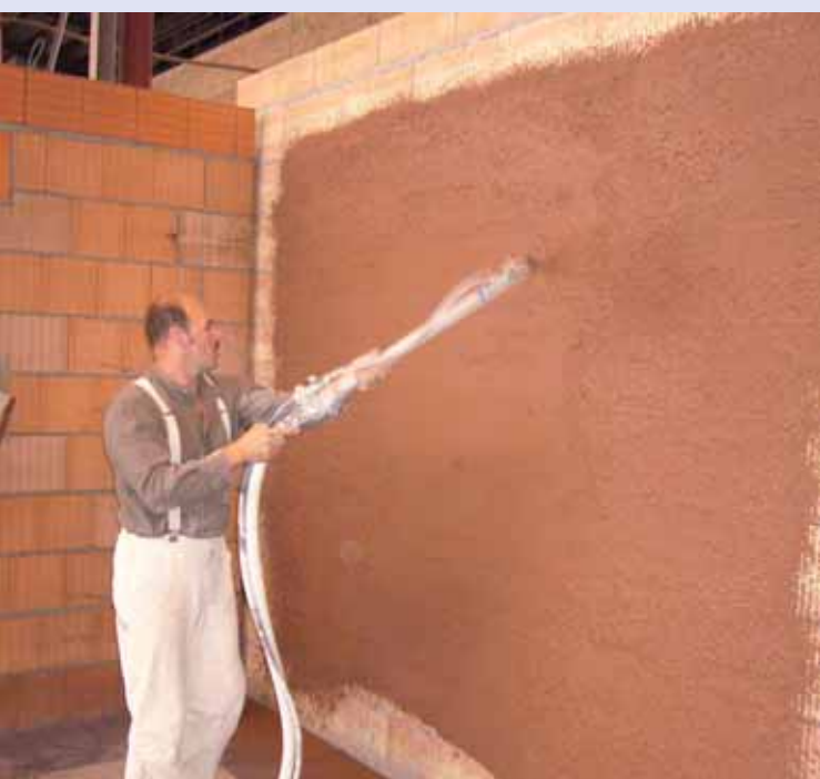
Lehmputz auf Poroton – keine feuchtesperrende Beschichtung
