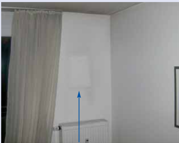
Untersuchungen – Fogging durch Schadstoffe
