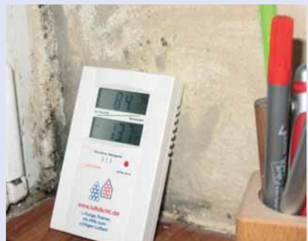
Schadstoffuntersuchungen / Schimmel auf Außenwand
