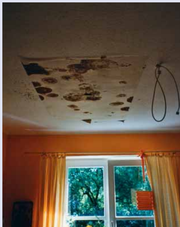
Schimmelbefall unter Tapete
